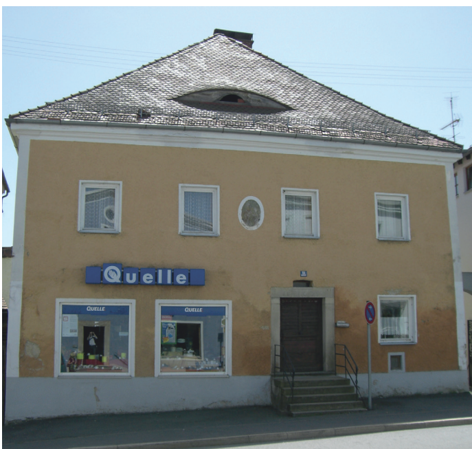
Fassade „Weiß-Haus“ vor Sanierung in Perlesreut
